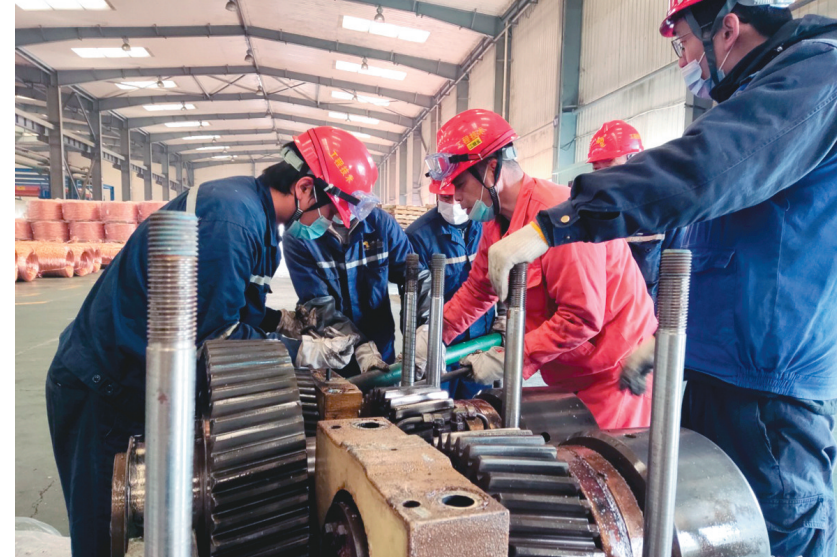
新年伊始,工程技术分公司继续保持与各业主单位沟通联系,认真履行生产维修保障职能,加强双休日和夜间维修值班,保障生产应急抢修工作的及时高效,近期重点加强元旦、春节期间生产维修值班值守,全力做好所服务企业的生产设备维修服务。
