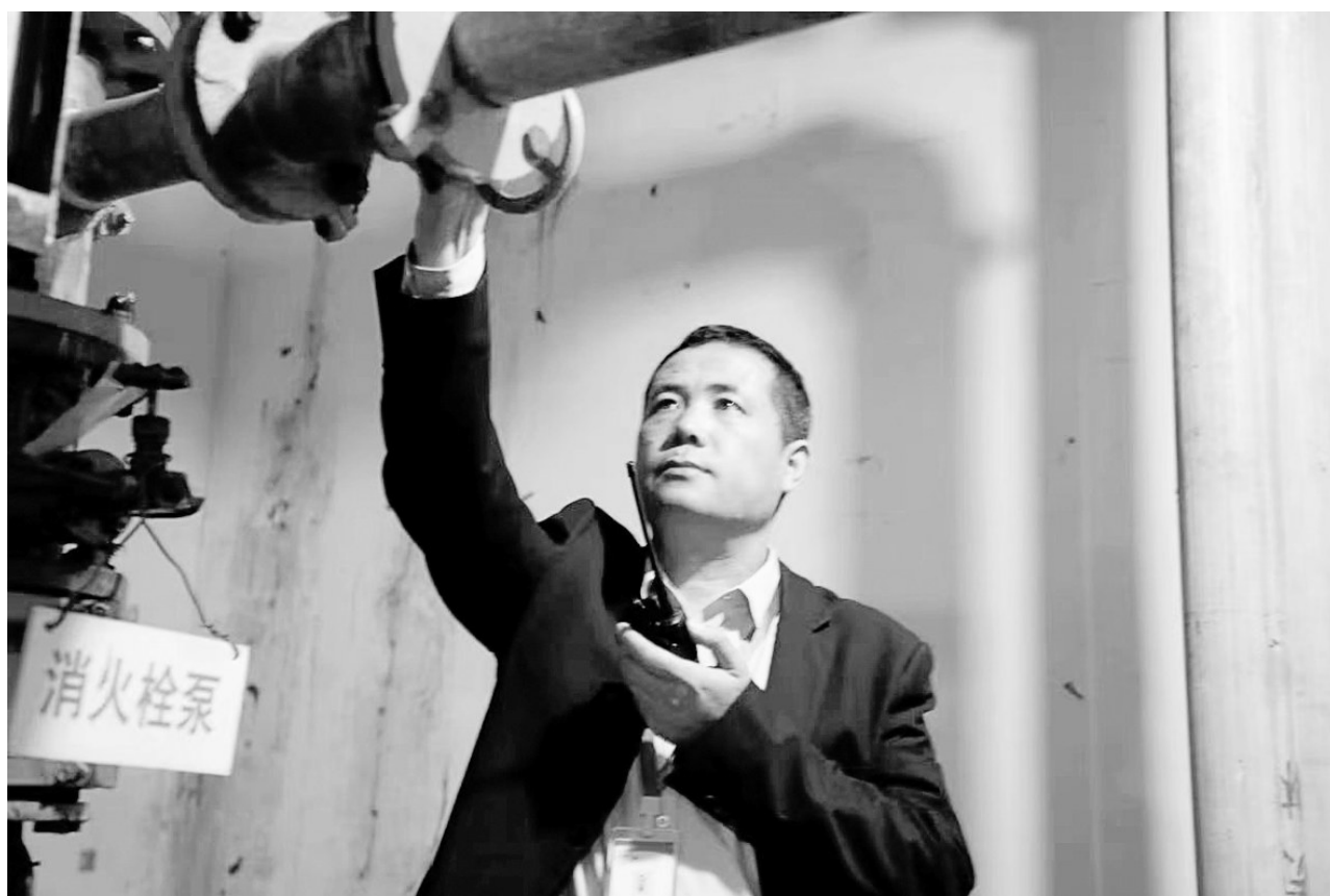
图为周爱春对铜冠花园12栋负一楼机房进行例行检查。
