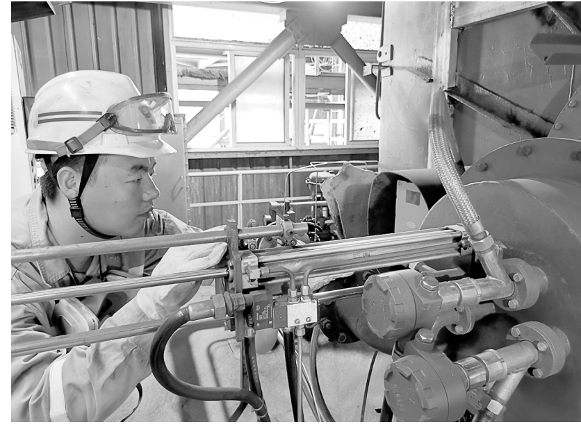
牛海涛正在观察冰铜磨系统国产化改造的新热风炉燃烧状况。
