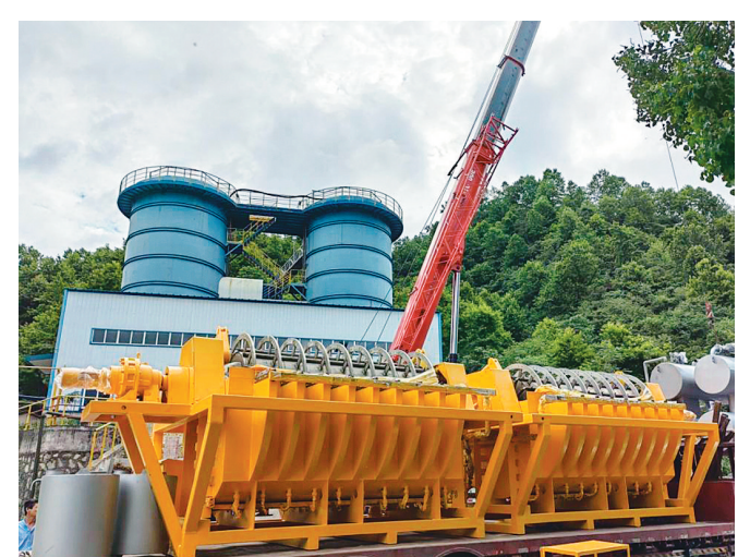
日前,铜冠投资金神公司党委2022年度“选矿尾砂综合利用”党建攻关项目进入设备安装调试阶段,标志着该项目取得实质性进展。图为设备安装时的场景。李伟伟 摄
