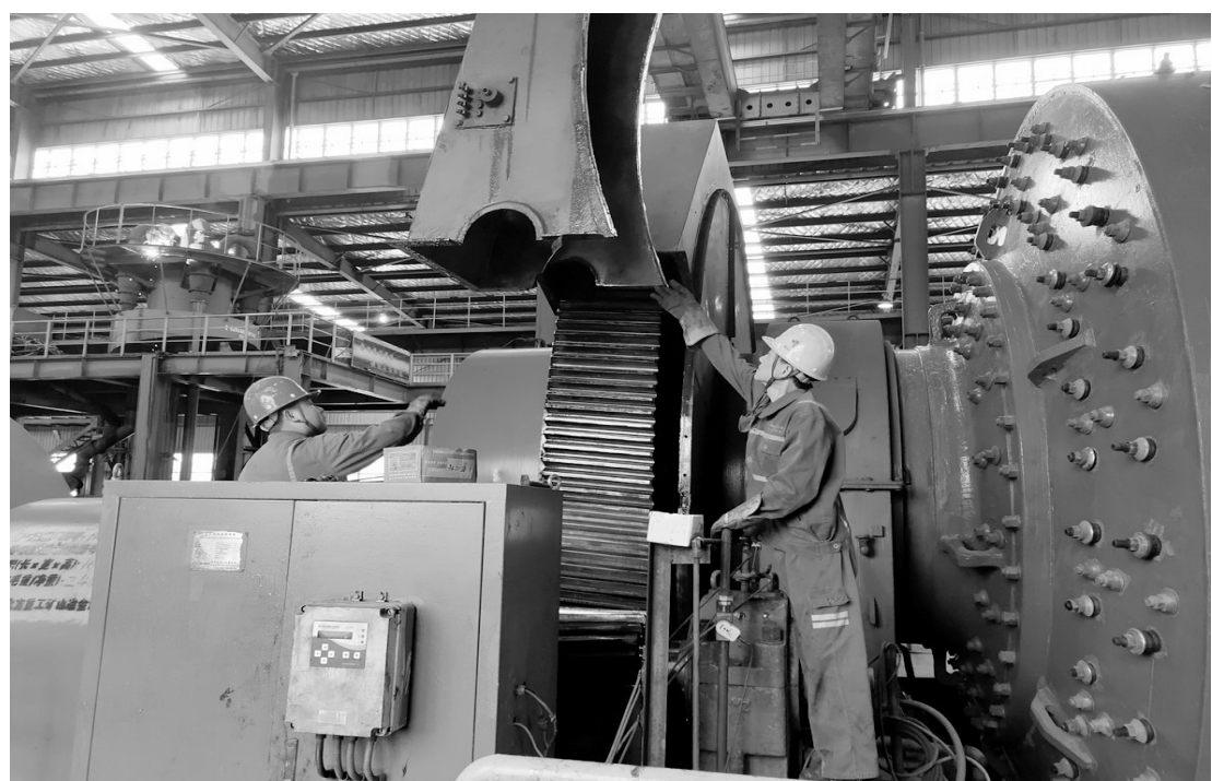
4月14日,铜山铜矿分公司组织专业技术人员检查选矿车间半自磨机小齿的磨损度及粘合度。今年,该公司以提高设备有效作业率为抓手,不断强化生产过程跟踪协调管理,坚持设备维护保养与预防性检修相结合,确保各类设备零故障,安全高效运转。 张 霞 唐玉弟 摄
