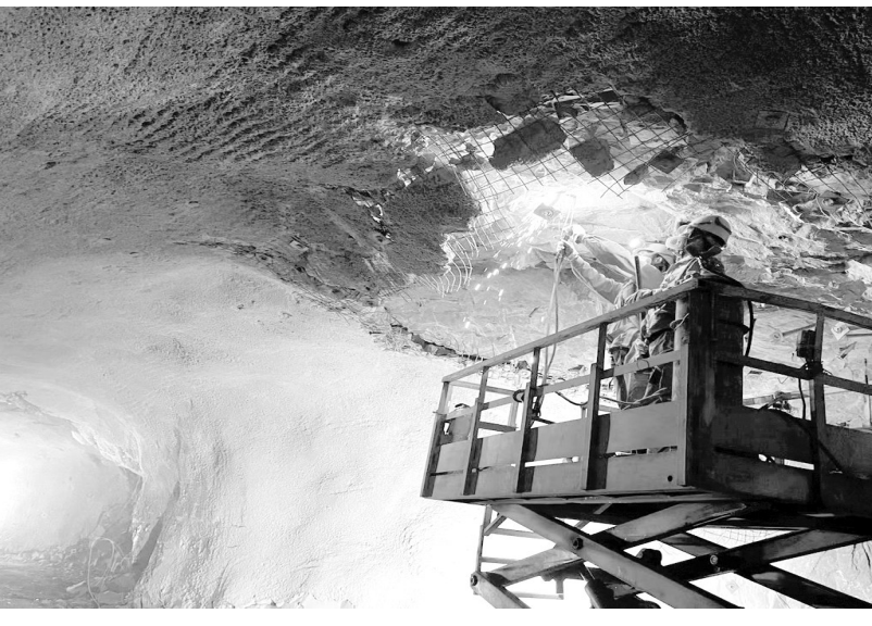
2月24日,铜冠(庐江)矿业公司员工利用升降平台车对井下出矿采场进路中的废旧锚杆进行清理回收。该公司对井下生产现场实行从严强化管理,抓实安全生产和规范操作,统一对采场进路中顶帮板延伸出来的锚杆进行切割回收,进一步提高了井下生产安全系数,使安全生产得到有效保障。陈幸欣 刘祥耀
