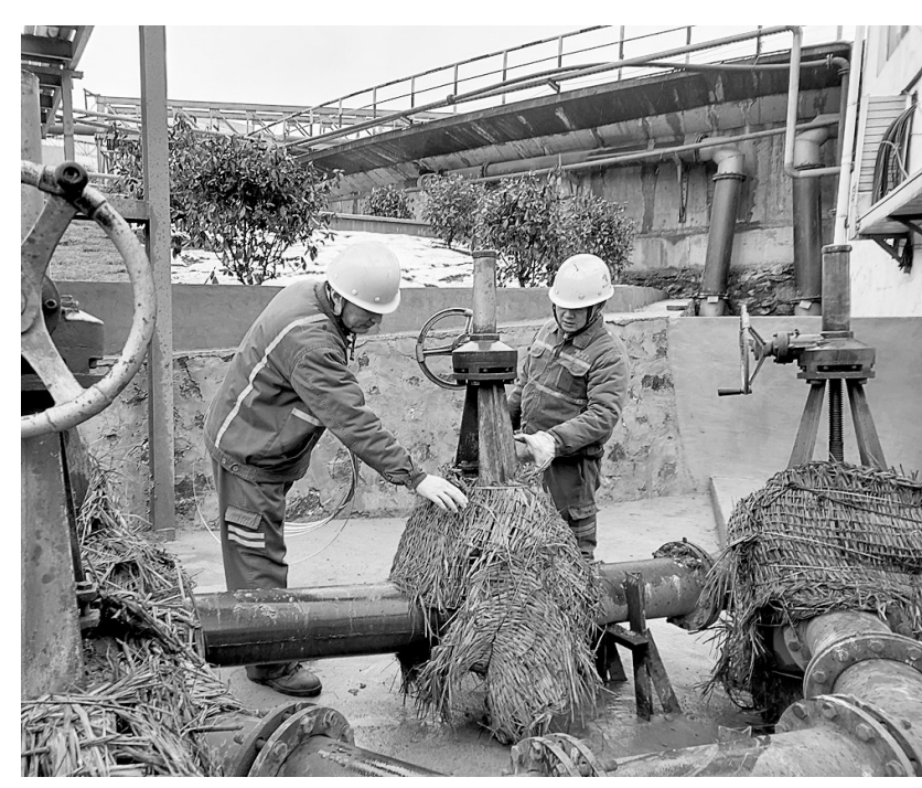
1月29日,铜山地区迎来入冬的首场降雪,气温已低至零下。为保障生产安全正常,铜山铜矿分公司组织人员冒雪对室外重要区域设备、管道进行巡视检查,全力做好极端天气防御工作,确保生产稳定。图为该公司选矿车间员工冒雪检查室外管道。张震唐玉摄
