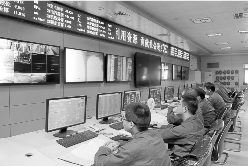
热电车间集控室。
