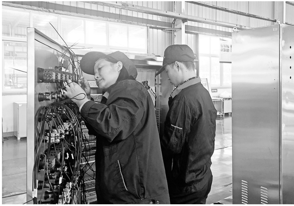
11月29日,铜冠建安电控设备厂职工正在车间内进行配电柜装配作业。这是该厂为承接的金磊矿业公司铜山矿区大凹山-寒山水泥用石灰岩矿980万吨每年露天开采项目所需配电设备组职工加班加点作业,积极采取措施保证质量工期要求,奋力冲刺工程节点目标。
