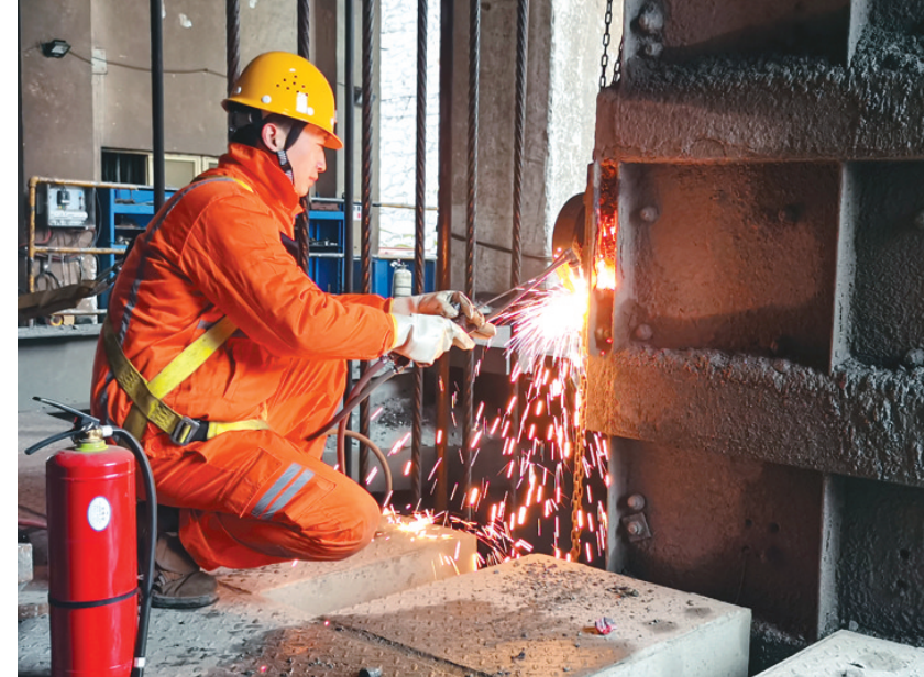
近日,冬瓜山铜矿提升一区维修人员正在气割已损坏的箕斗引轮。进入四季度以来,该工区加强设备的巡查和维护,狠抓关键重点设备的维护保养,确保关键设备安全稳定高效运行,为冲刺全年目标任务打下坚实基础。
