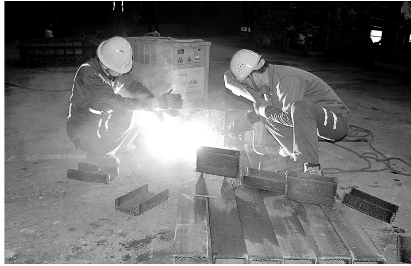
日前,天马山矿业公司选矿车间积极开展5S活动,对车间露天备件库进行整理,备件材料分类摆放。图为车间人员正在制作管道摆放支架。朱 艳 王刚强 摄
