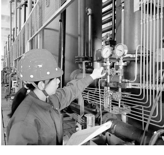
有色动力厂热车间除盐水生产是满足热电厂锅炉补水生产运行的重要环节,也是对外供应用户的重点保障线。今年以来,该厂按照国家电力行业标准,紧盯技术指标,严格落实生产责任,努力从生产设备数据控制和实际生产运行效果分析上寻求突破,全力促进产量和质量稳步提升。图为该厂热车间间化值班员工正在认真监测关键设备技术数据实际运行情况。 罗 鹏 摄
