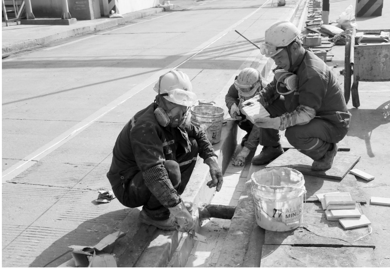
金隆铜业公司在生产过程中注重环保管理,对贵金属冶炼过程中产生的废水排放进行严格管控,全部收集进行再处理,即使在废水流入回收系统的途中,也采取严密措施防止向地下渗透,确保全过程安全可控。图为相关人员正在用耐腐蚀材料铺设废水经过的地沟。 章 庆 摄
