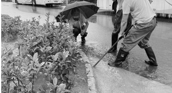
连日的暴雨袭击池州，铜冠铜箔公司多处排水沟出现堵塞，严重危及公司财产和生产安全。该公司五六工场应急小分队头行动，对排水沟、下水井进行清理。图为该工场应急小分队成员正在对溶铜排水沟进行清理。 吴 猛 摄
