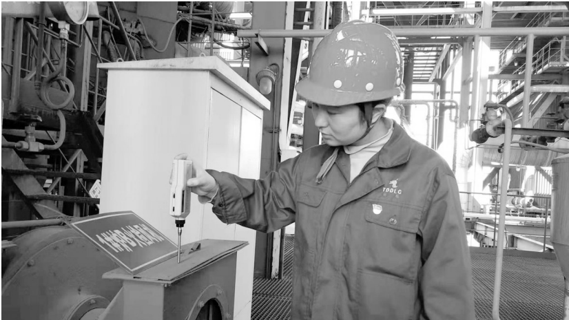
为保障刚刚并炉成功的热电系统1号锅炉安全正常运行,动力厂热电车间锅炉班组对锅炉的各个关键设备开展细致的监控排查工作。图为职工在现场检查相关设备的实时运行情况。 尹 隼 摄
