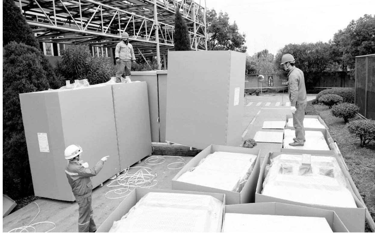
日前,金隆铜业公司设备验收人员正在新到的一批高压配电柜卸货现场进行监督指挥(如图)。据悉,此批高压配电柜是该公司电解课常规电解高配更新专项,通过高压配电柜整体更换,优化了供电回路,使其安全稳定,从而更加确保该公司安全生产稳定进行。
