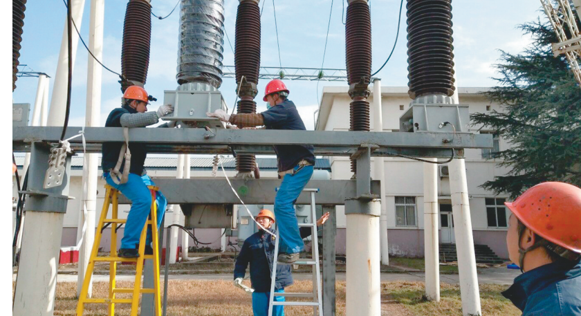
新年一开年,安庆铜矿就掀起了大年热潮,按照矿部要求,各生产单位积极开展“开好头,出实绩,保安环”的行动,让新年呈现出新气象。图为该矿动力车间正在抓紧利用晴好天气,对矿山110千伏供电设备进行维护。
