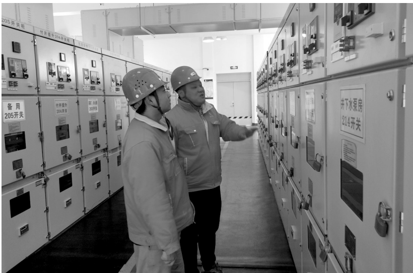
铜冠(庐江)矿业公司动力运转中心全力做好冬季供电安全保障工作。近日,该中心组织电气专业和维修人员开展冬季供电系统巡查,重点检查了矿区外两条进矿110千伏架空线路,将检查中发现的隐患记录并上报至能源管理部门。图为该中心员工正在检查总降设备。
