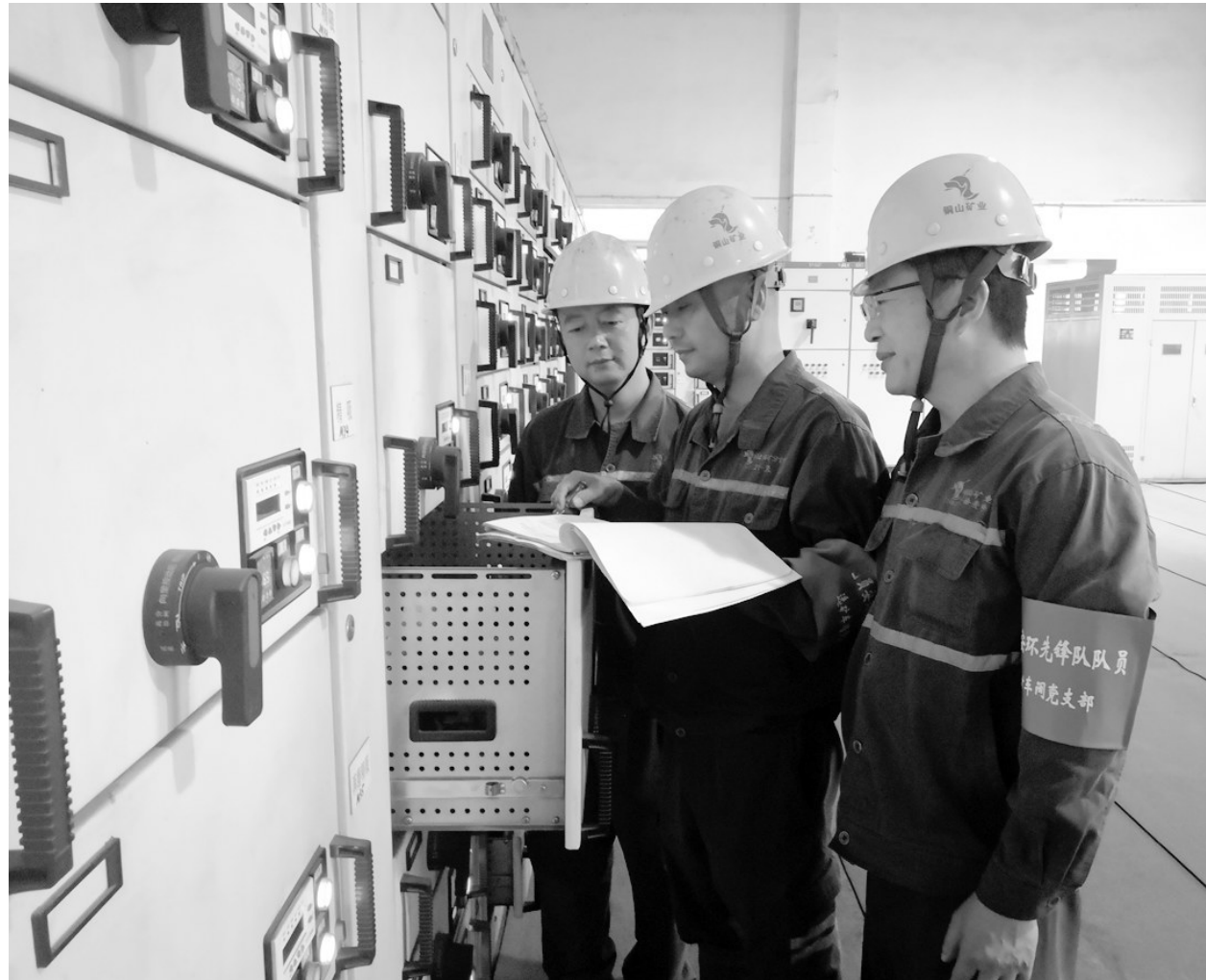
10月6日,铜山铜矿分公司选矿车间党支部安环先锋队组织队员对选矿主配电站电气控制柜进行检查。该车间党支部为发挥安环先锋队作用,定期组织队员排查并消除隐患,确保选矿生产系统高效运转。
