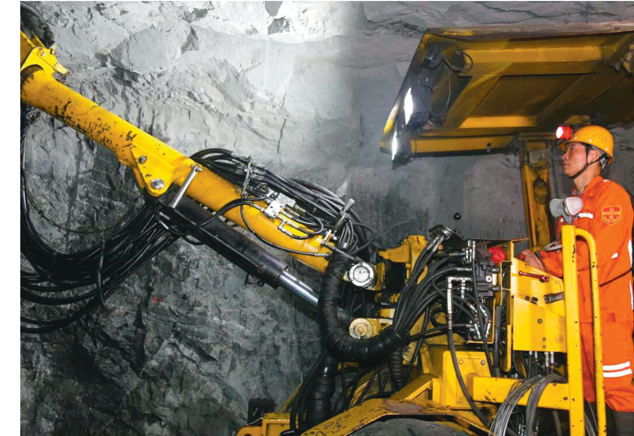
9月28日,冬瓜山铜矿掘进一区一线职工正在负980米中段采场进行凿岩作业。俗话说“矿山开采,掘进先行”。该工区广大职工面对井下作业通风差、温度高等不利因素,坚持“操修合一”的管理模式,有效提高了生产效率。据统计,三季度,该工区就完成掘进量17743.4立方米。 汤菁 夏侯宜 摄
