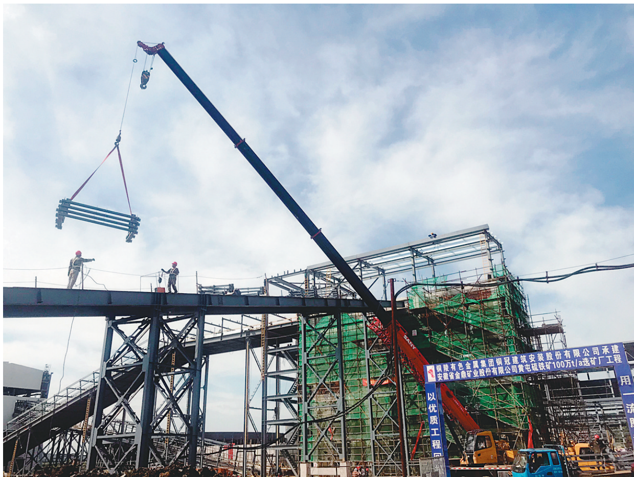
日前,庐江安徽金鼎矿业选矿系统工程项目建设现场,铜冠建安公司的建设者们奋战在现场各施工点。他们顶高温、战酷暑、抢工期,土建、钢构、安装各交叉专业交叉施工,加快推进工程整体建设进度,以满足业主主要求。图为员工正在吊装皮带廊架。
