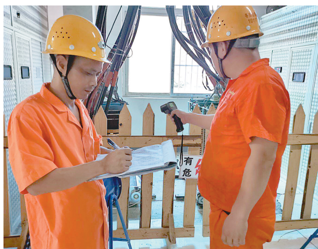
日前,冬瓜山铜矿提升一区职工对电气设施柜头进行点检测温。天气炎热,设备温度快速升高,对室内外电气设备的运行带来了严峻考验。该区积极落实电气设备巡检测温工作,在环境温度升高时及时启动通风降温、冷却调节措施。
