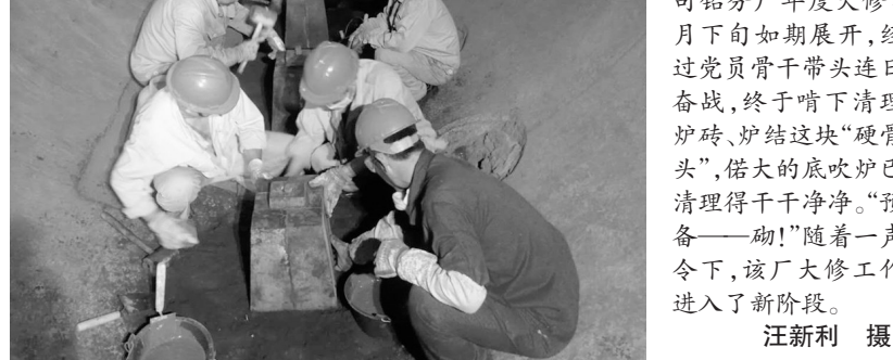
铜冠有色池州公司铅分厂年度大修4月下旬如期展开，经过党员骨干带头连日奋战，终于啃下清理炉砖、炉结这块“硬骨头”，偌大的底吹炉已清理得干干净净。“预备——砌！”随着一声令下，该厂大修工作进入了新阶段。 汪新利 摄
