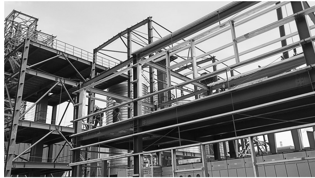
铜冠建安建材公司年产30万吨矿山充填胶凝材料生产线技术改造项目正在加紧施工作业。该项目目前进入最后的冲刺阶段,为了保证集团公司这项重点工程按期完成,土建、钢结构、安装各专业倒排计划,加班加点推进工期,努力保质保量完成任务。 王红平 汪锡铜 摄
