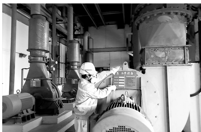
日前,金冠铜业分公司统一为车间重点设备更换标识牌,这些新“身份证”将便于生产、检修人员掌握相关设备信息和设备管理人员有效跟踪设备运行情况。图为精炼车间人员正在为风机更换设备标识牌。 萨百灵 马 敏 摄
