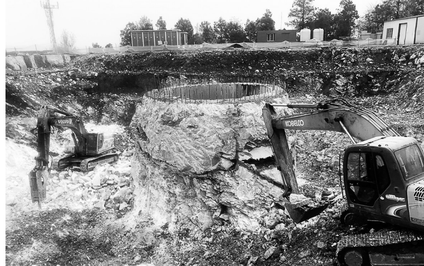
4月4日,铜冠建安公司第二建筑工程事业部正在冬瓜山铜矿新辅助井井塔工程进行深基坑土石方挖运作业。该工程建设总工期360天,施工技术难度大,安全质量要求高,该公司事业部充分准备,精心策划,编制专项施工方案,严格按照施工进度网络计划组织施工,努力把控工程的每个节点,有序推进。王红平 汪锡铜 摄
