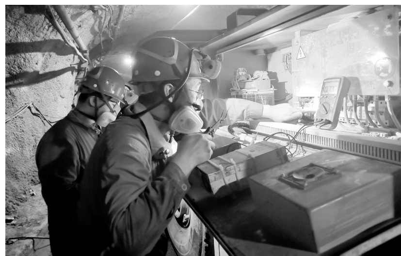
连日来,铜冠(庐江)矿业公司在做好疫情防控的同时,切实抓好井下铲运机维护保养工作,确保疫情防控期间生产顺畅。图为该矿井下负770米中段电铲维修点,维修人员正在对LH409E铲运机零部件进行检查维护。
