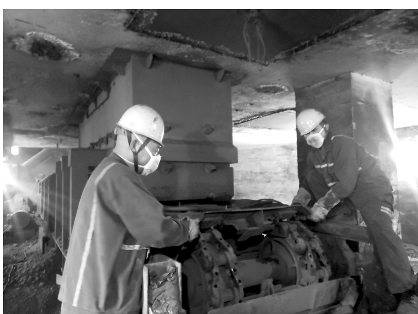
3月6日,铜山铜矿分公司选矿车间维修工在维护保养2号铁板机。该车间未雨绸缪,利用矿山备泉水矿间隙,对选矿机电设备进行了全面的排查和维护,确保设备完好率、运转率均达百分之百。
