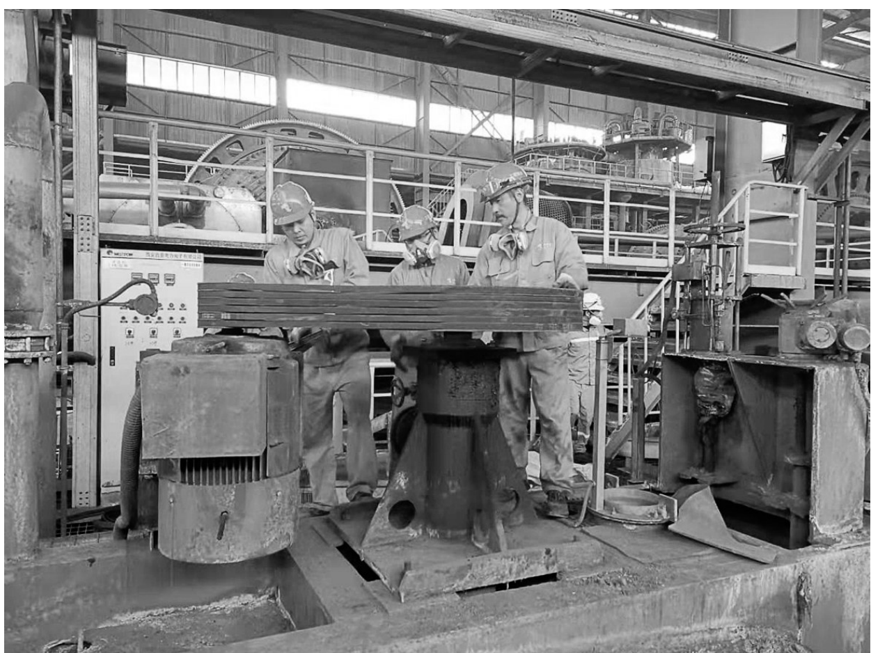
工程技术分公司金隆项目部合理安排各项检修任务,并充分利用自身技术优势积极承接维修项目,提高自修产值。10月14日,该项目部组织精干力量投入金冠铜业分公司12台浮选机设备大修施工项目,检修人员连续奋战13天,于10月26日提前完成此项大修项目。图为现场检修人员在项目结束前进行浮选机三角皮带安装调试场景。 王璐 摄
