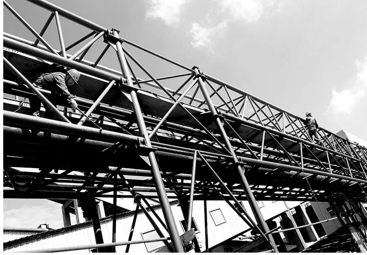
金隆铜业公司十分重视水、气等输送各类生产资源的管道安全,定期开展管道点检巡查。今年以来,该公司对南、北两个厂区的高架管道进行了集中防腐维护,以保证管道运输安全。图为相关人员正在为管道涂刷防腐漆。章庆 摄
