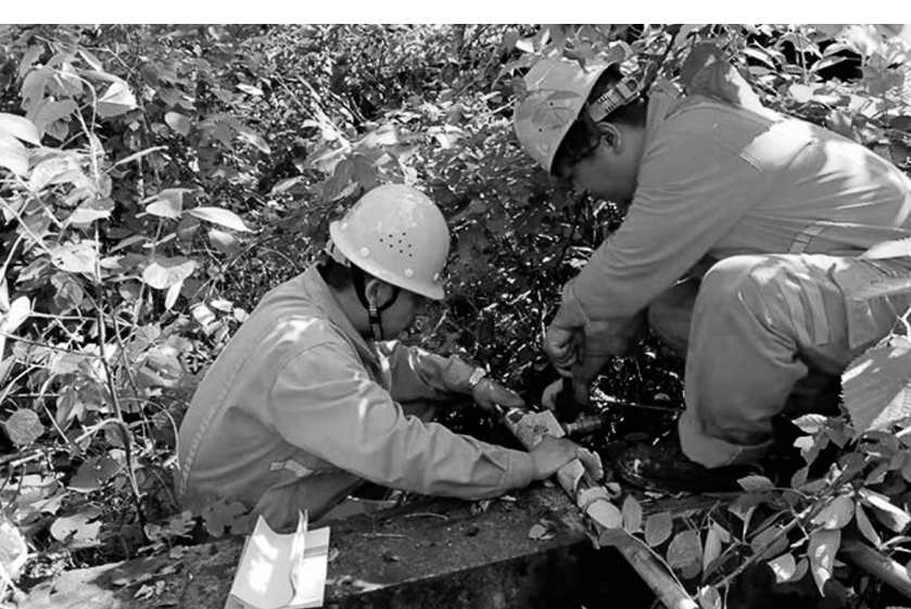
今年以来，冬瓜山铜矿持续做好降本增效工作，加强材料、备件管理等各个环节的监管，防止跑冒滴漏现象。近期，该矿组织人员对矿山生活供水管道进行全面检查，发现跑冒滴漏问题立即整改(如图)，确保生活用水正常，有效避免水资源流失。 汤青 陶信宁 摄
