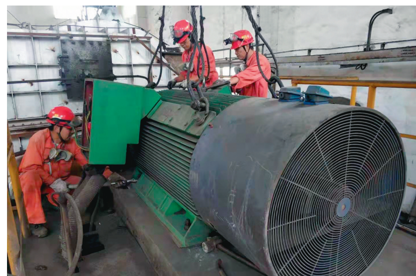
工程技术分公司金冠项目部电仪班承接的金冠双闪厂区大修项目——双闪排风机房560千瓦电动机安装,电动机体积较大,技术难度大,计划工期3天,现场检修人员加班加点,仅用一天半时间提前完成任务,稳步推进了大修整体进度。图为检修现场。
