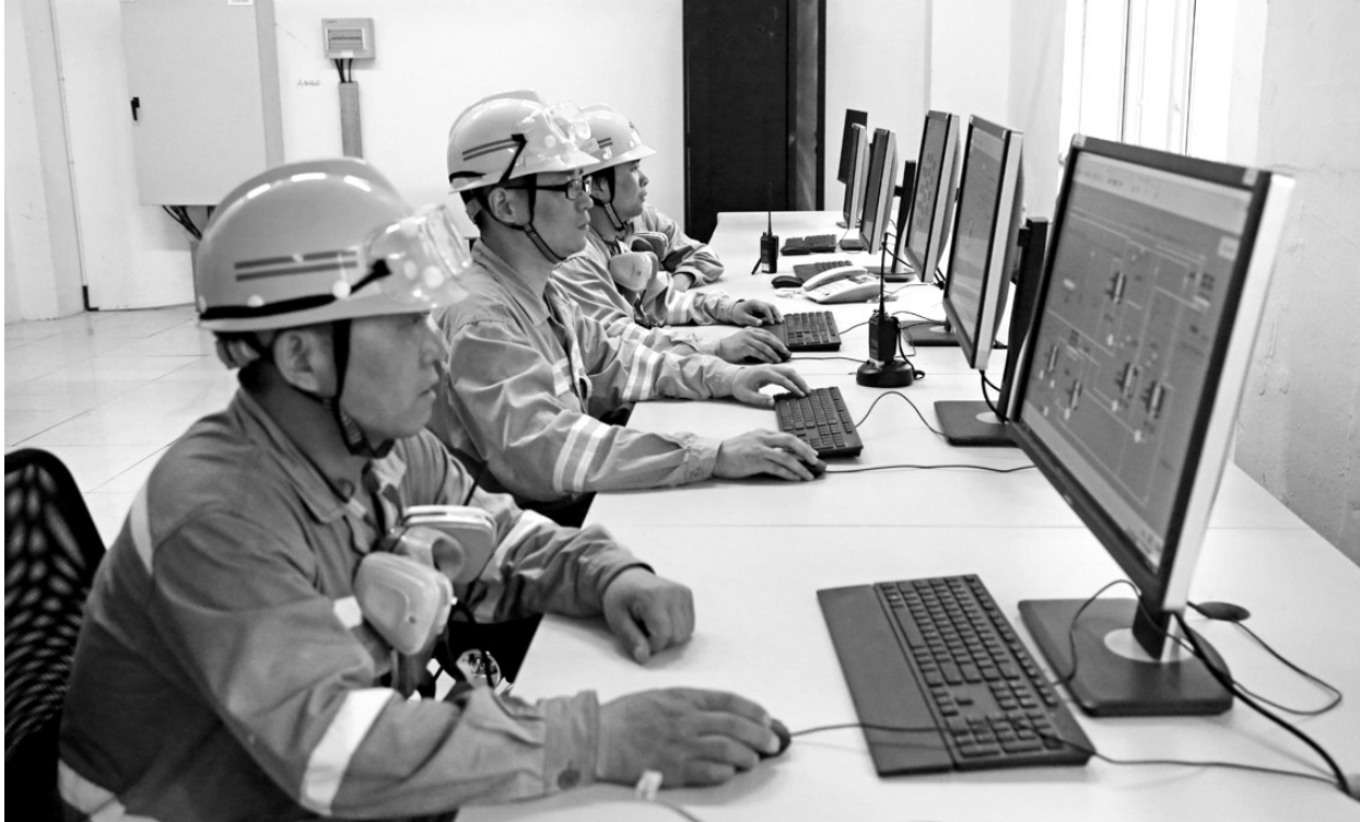
金冠铜业分公司职工日前正在新投产的铜阳极泥资源综合利用项目中监控设备运行。金冠铜业分公司自铜阳极泥资源综合利用项目点火及投料后，积极通过主控室加强对卡尔多炉等主要设备磨合情况的跟踪监控，努力确保项目在试生产中平稳运行。
