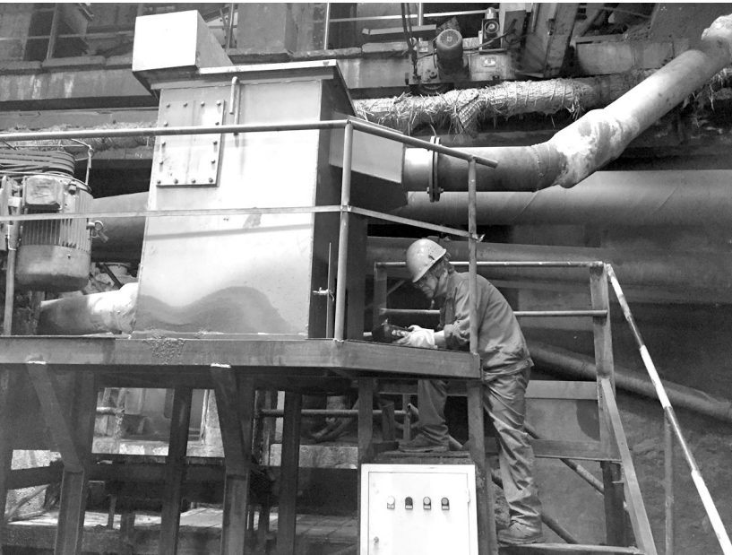
为提高金矿取样的准确性,天马山矿业公司选矿车间安装调试了往复式自动取样器。该取样器在设定时间内定时对金矿矿浆取样,保证了生产数据的准确性和稳定性。图为该公司工作人员正在调试取样器。
