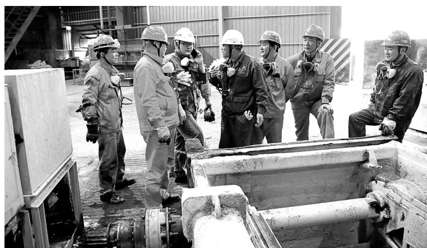
金隆铜业公司冶炼技术人员正在和本次设备大修的主要维修单位工程技术分公司相关人员商讨协调维修事务。本次设备大修中,金隆铜业公司注重和维修单位深入沟通交流,以便随时解决检修中出现的任何疑难问题,保证本次设备大修按照预定的时间节点向前推进。
