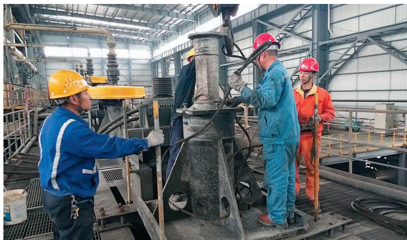
日前,铜冠(庐江)矿业公司部分选矿浮选机出现轴承损坏、摆动异常等问题,为避免生产易造成电流过高的影响,这个公司及时组织维修人员对此类“异常”浮选机进行更换,排除安全隐患(如图)。
