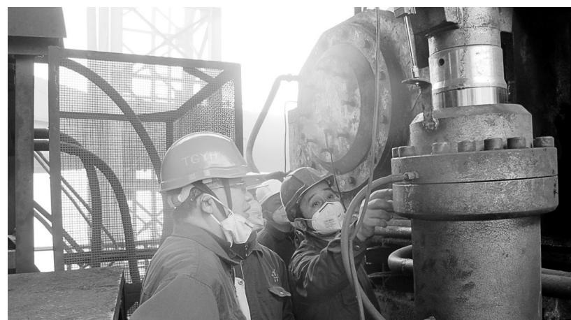
2月5日,正月初一,铜冠冶化分公司球团车间分管领导、点检员、操作工正在对回转窑液压挡轮进行检查。为确保春节期间生产安全,球团车间积极完善设备管理制度,强化设备点检力度,提高点检效率,确保春节期间生产设备正常运转。
