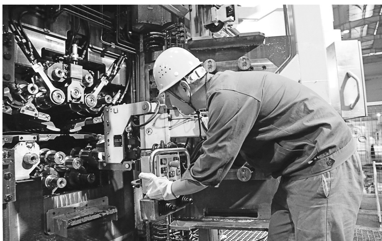
金威铜业分公司职工目前正在对SDW精轧机开展例行检修。金威公司在新的一年里将继续深入推进TPM管理活动,强化操作点检和设备两清,建立班组长设备操作点检和润滑负责制度,不断推进“运修合一”,坚持设备每周定期停机检修维护制度,保障生产的持续有效运行。
