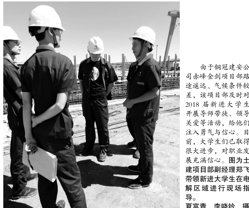
由于铜冠建安公司赤峰金矿项目部路途遥远、气候条件较差,该项目部及时对2018届新进大学生开展导师带徒、领导关爱等活动,给他们注入勇气与信心。目前,大学生们已取得很大进步,对职业发展充满信心。图为土建项目部副经理郑飞带领新进大学生在电解区域进行现场指导。 夏富青 李晓铃 摄
