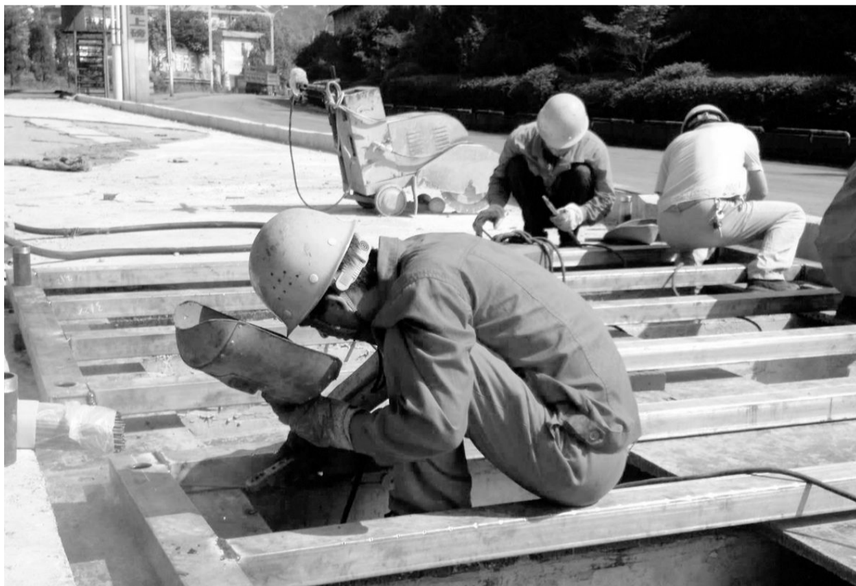
日前,天马山矿业公司选矿车间员工冒着酷暑,露天作业进行地磅房安装洗车器工作。完成安装后,将有效降低路面粉尘,改善矿区环境。 朱艳 黄叶贵 摄
