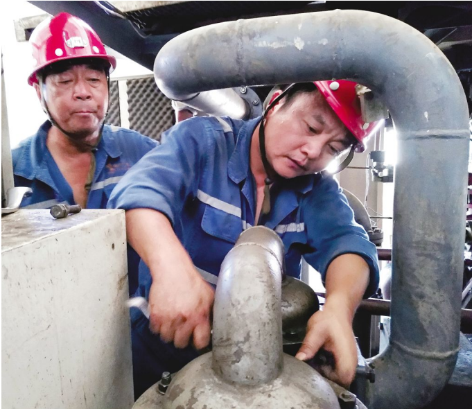
铜山铜矿分公司员工在狭小闷热的空压机箱体内工作。 张震 黄武 摄
