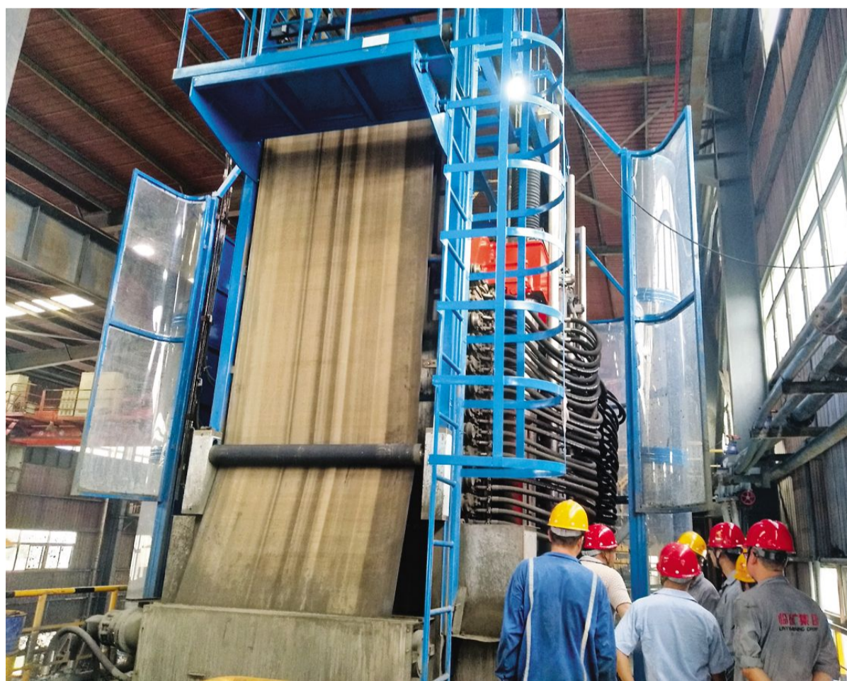
日前,铜山铜矿分公司与设备厂方专业技术人员对新安装的压滤机进行调试。据了解,该分公司针对硫精矿粒度细、含泥大,靠陶瓷过滤器过滤不能满足脱水要求,既造成产品流失,污染环境,又造成一定经济损失,经过多方探讨研究,改用压滤机替代原陶瓷过滤器,彻底解决硫精矿脱水的问题,有效提高产品质量。 张霞 陈斌 摄
