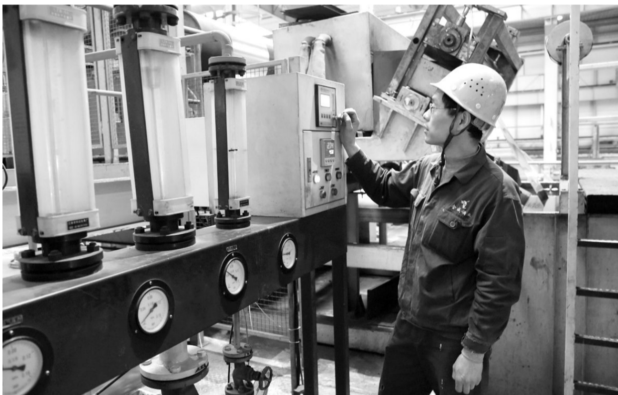
金冠铜业公司职工日前正在巡查气垫炉混气站保护器运行情况。该公司板带生产系统中的650和1250气垫式退火炉因存在混气站氨含量超标带来爆炸危险的因素，为了保证两条气垫炉混气站的安全使用，该公司在向德国容克公司及德国WSP公司两个气垫炉制造商进行咨询的前提下，采取了对混气站进行了安全系统的改造措施，从而消除了安全隐患，保证了混气站安全系统安全运行。 王红平 黄军平 摄
