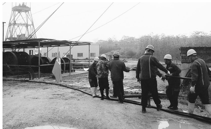
日前,铜冠矿建公司姚家岭项目部党支部“党员活动日”组织党员义务奉献,突击完成姚家岭矿1号探矿井井下泵房高压电缆投放工作,加快了井下泵房的安装进度,为提升排水能力做好准备。 刘勇 摄
