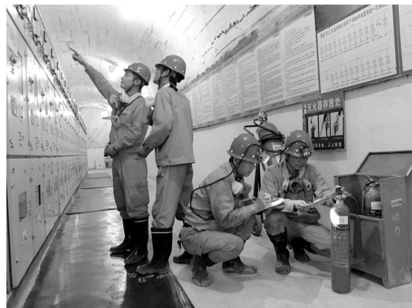
近日,安徽铜冠(庐江)矿业公司动力运转中心组织人员对井下供电设备进行巡查。汛期来临,该中心每周定期组织电气维修和水电巡查人员开展供电设备巡查,及时消除隐患,确保汛期井下供电和消防器材完好。 夏富青 包民摄
