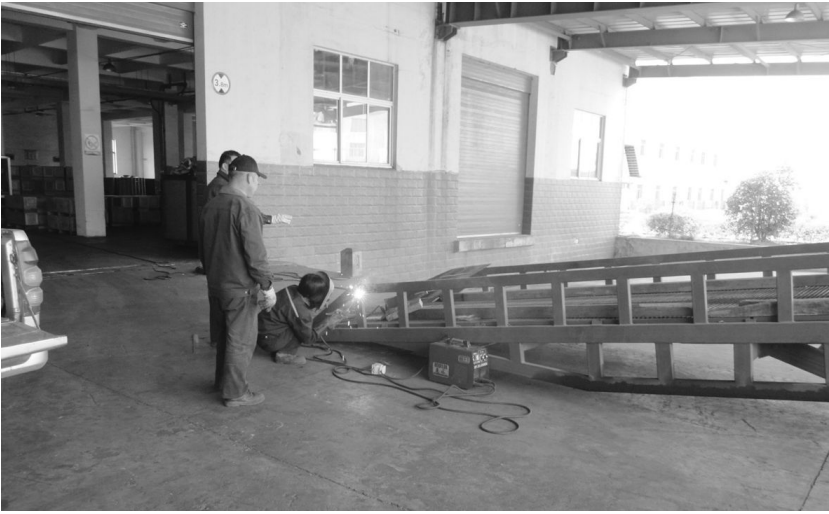
金运物流分公司在安全巡查中发现，驻安徽铜冠铜箔有限公司业务点的登车桥体有脱焊现象，存在安全隐患。为保障作业安全，保证上游客户的产品及时顺利外发，该分公司紧急与兄弟单位联系，在第一时间圆满完成了登车桥的焊接修复工作。
