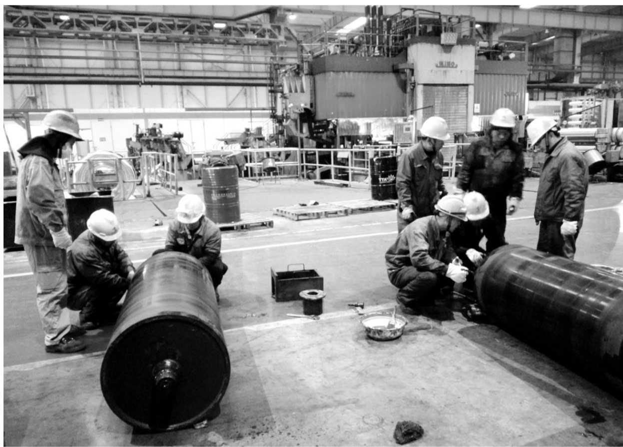
近日,铜冠建安安装公司承接到2018年春节前金威大修项目,按业主要求九天时间(大年初二至初十)完成所有工作量。安装公司项目负责人与技术人员提前与业主沟通,组织讨论。春节期间组建一支由60名经验丰富专业技术人员组成的精干高效施工队伍,安装公司领导和管理项目人员全程参与施工。图为正月初六在金威公司现场施工。本报记者 江君 通讯员 黄世群 摄
