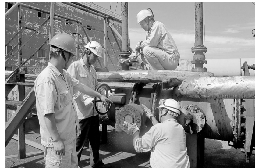
日前,铜冠冶化分公司球团车间开展大修前隐患排查活动。检查组对原料系统高压辊磨机、强力混合机和三大主机链篦机、回转窑、冷环机等重点关键设备进行了认真地检查,对查出的隐患按表要求立即落实整改,确保按质、按量地完成年度球团系统大修工作。图为检查组成员在检查煤气加压站进气阀门。李文波 摄
