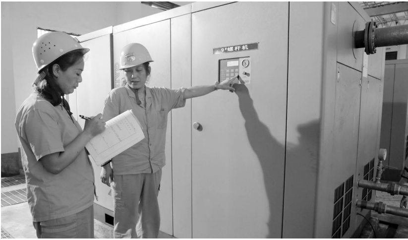
冬瓜山铜矿动力车间运转班所管轄的12台60立方的压风机，是提供全矿井下打眼、爆破装药等风动机械和设备的动力。进入夏季以来，受井下用风需求量增加以及气温居高不下等因素影响，每天的中班和夜班压风机运行率都是100%。该班为了确保生产稳定有序，一方面强化岗位工安全责任意识，缩短巡查时间，勤检查、勤记录、勤汇报；另一方面，加强维护、保养，坚决不让设备“带病作业”。图为该班操作人员在记录压风机运行情况的场景。杨李军 摄
