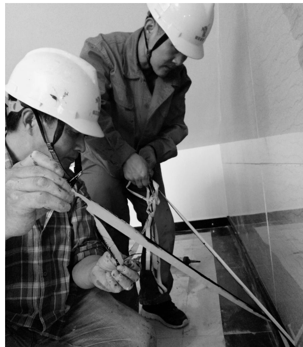
铜冠装饰装潢公司在重点工程奥炉员工食堂建设过程中,严格按照施工设计方案,精心组织,科学合理部署,对装潢细节一丝不苟,有效提升了该公司员工操作技能。图为5月22日,该公司员工黄传顺和黄小平蹲在地面,对仿石材高分子墙面装饰板作美纹纸的收口工作。本报记者 江君 通讯员 汪文萍 摄
