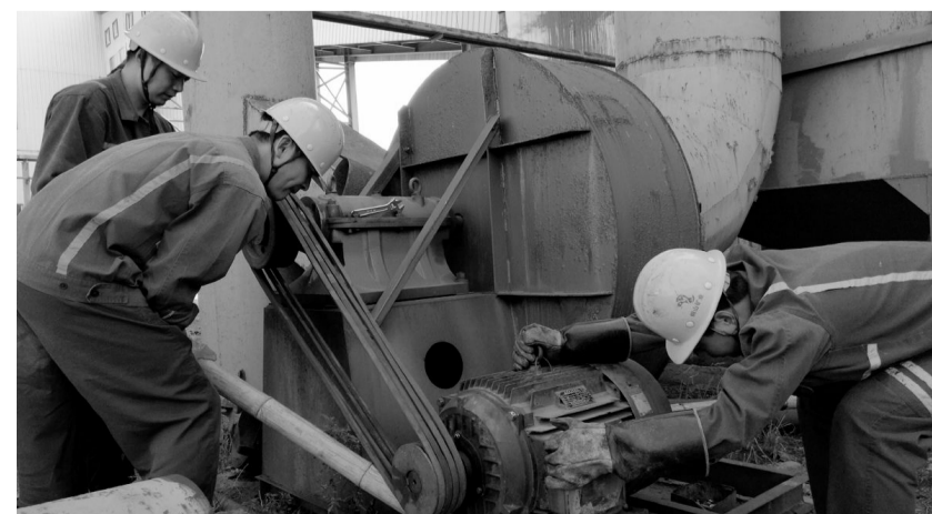
铜山矿业公司加大环保整治力度，积极推进绿色矿山建设，努力打造环保生态矿山。该公司采取措施有效降低作业现场的粉尘浓度，保证吸尘设备的运转正常，确保厂房内空气清新。图为近期该公司选矿车间人员正在对吸尘设备进行维护与保养。洪同国 摄
