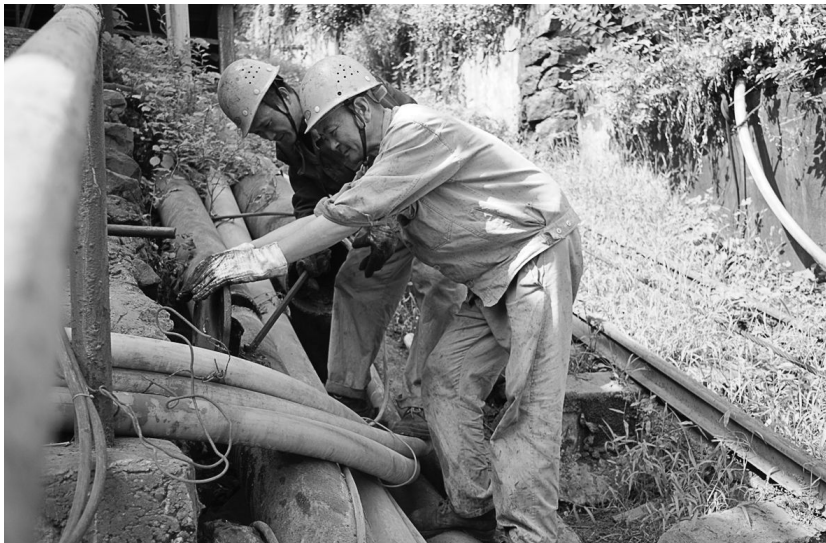
日前,天马山矿业公司利用停产检修时间,积极开展生产设备“诊检”工作,对存在的安全隐患和损坏的部分设备及时进行整改、更换,确保后续生产安全正常运行。
